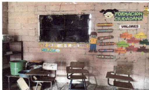
Foto 4: PISO DETERIORADO Y DESNIVELADO
