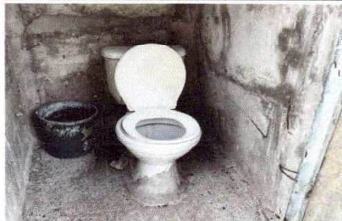
Foto 8: INODOROS MAL INSTALADOS Y DAÑADOS, ADHERIDOS CON MEZCLA NO ADECUADA AL MATERIAL.
