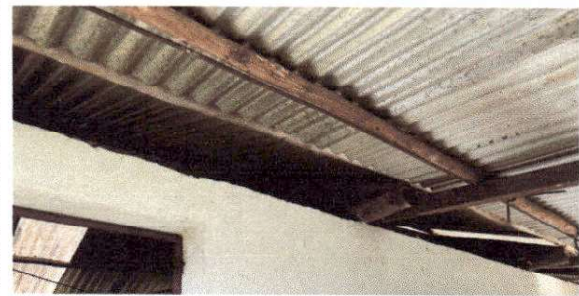
Foto 6: LAMINA DE DIRECCION ANTICUADA Y CON PROBLEMAS DE FILTRACIONES.
