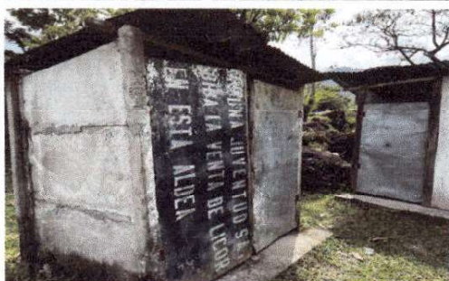
Foto 9: MUROS CON FALTA DE MANTENIMIENTO DE LOS SANITARIOS.
