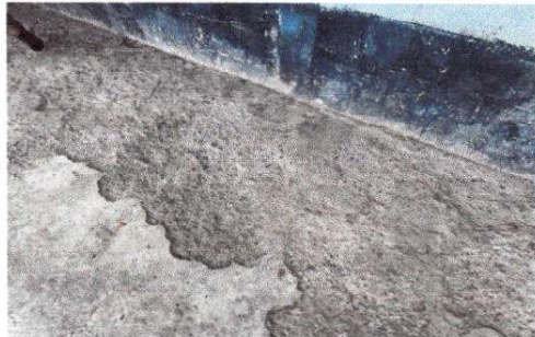
Foto 2: CORREDORES DE MODULOS DE AULAS, DETERIORADOS E IRREGULARES.
