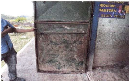
Foto 3: PUERTAS DE METAL DE LAS AULAS EN MALAS CONDICIONES Y OXIDADAS.
