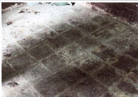
Foto 3: AREA DE DIRECCION DEL MODULO, CON PISO DETERIORADO.
