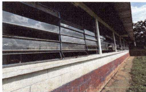
Foto 3: VENTANAS DE AULAS, SIN VIDRIOS O VIDRIOS DAÑADOS
