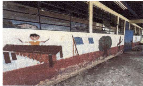
Foto 2: PINTURA EXTERIOR DEL MODULO DE AULAS, DETERIORADO.
