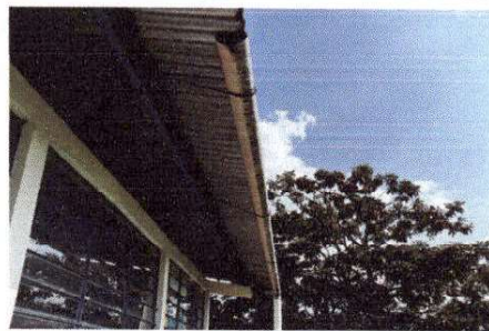
Foto 6: BAJADA DE AGUA PLUVIAL, IMPROVISADA CON TUBERIA DE PVC.
