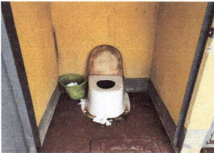
Foto 9: DETERIORO DE PINTURA DE MUROS DE SANITARIOS Y PUERTAS.
