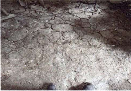
Foto 7: EL PISO DEL AREA DE LA COCINA ACTUALMENTE ES DE TIERRA.
