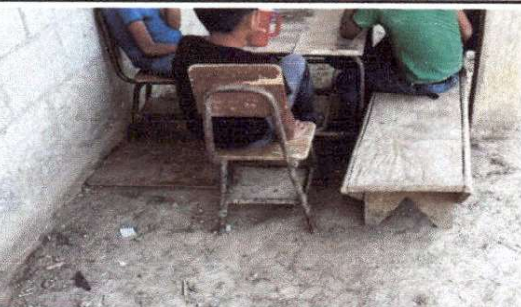
Foto 5: UNA DE LAS AULAS NO CUENTA CON FUNDICION DE TORTA DE CONCRETO, DANDOLE USO SOBRE TIERRA.
