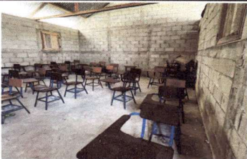
Foto 3: AULAS NO CUENTA CON PINTURA INTERIOR NI EXTERIOR.
