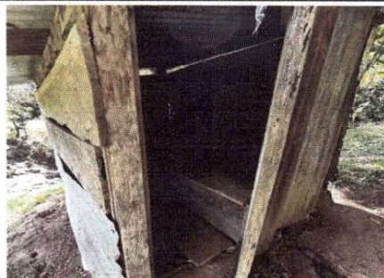
Foto 10: LETRINAS DE MADERA INACCESIBLES Y PODRIDAS.
