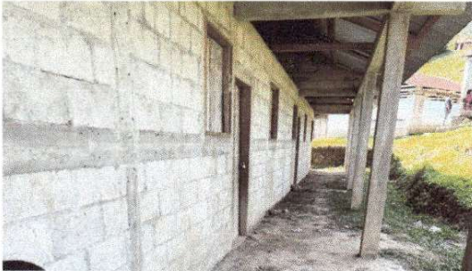
Foto 7: NO CUENTA CON FUNDICION DE CORREDOR NI REPELLO EN MUROS.
