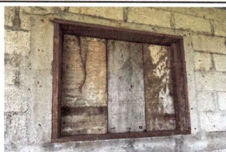
Foto 6: AL IGUAL QUE LAS PUERTAS, NO EXISTEN VENTANAS Y PROVISIONALMENTE SE COLOCO MADERA PARA CUBRIR VANOS.
