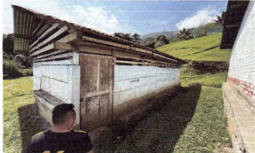
Foto 8: LA CUBIERTA DE LAMINA DE LA COCINA, ES CON LAMINADA RECICLADA (DETERIORADA).
