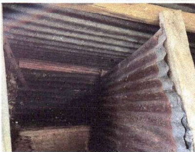
Foto 9: ESTRUCTURA DE SANITARIOS, EN PESIMAS CONDICIONES.
