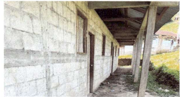
Foto 2: VISTA DEL MODULO NUEVO DE AULAS, EN FUNCIONAMIENTO PERO INCONCLUSO.
