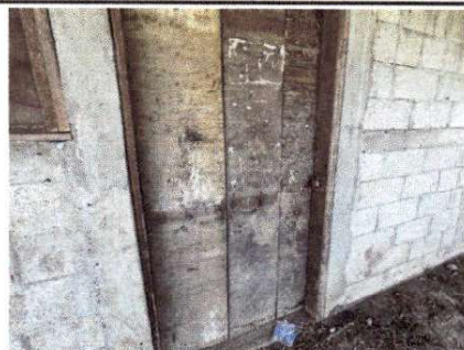
Foto 4: PUERTAS DE AULAS IMPREVISTAS, DE MADERA.
