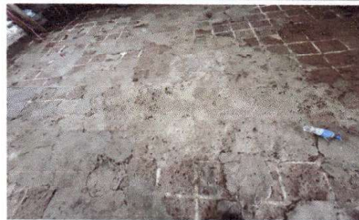
Foto 4: PISO DETERIORADO Y DESNIVELADO
