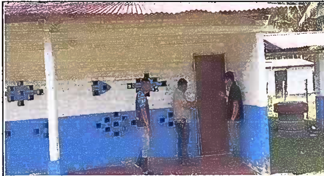
FOTO. 1 Modulo I: Sustrición de puertas
