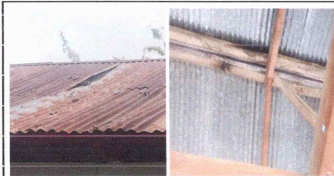
Foto 3: Aula No. 3 techo y vigas en mal estado.
