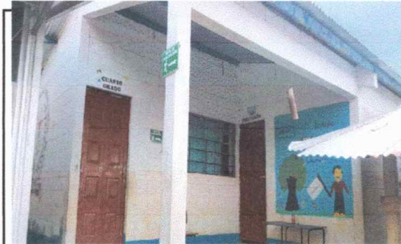
Foto 4: MODULO DOS, Sustitucion de lámina, por lámina troquelada aluzinc calibre 26. Sustitucion de capotes de lamina por lamina troquelada.
