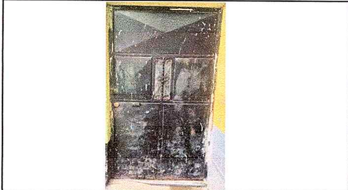
Foto 1: MODULO 1-Mantenimiento a estructura de puerta de metal (lijado,cambio de tubo, cepillado,sujeciones,aplicación de pintura.
