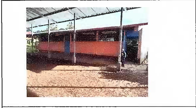
FOTO 2: pintura en muros exterior
