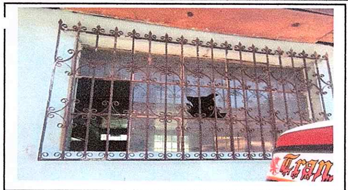
Foto 2: vidrios quebrados de las aulas de la EORM
