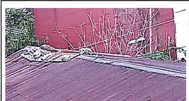
Foto 2: Tratando de evitar las grandes goteras en varias aulas.
