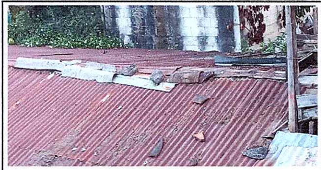
Foto 3: Toda la lámina del techas está totalmente oxidado y perforado.
