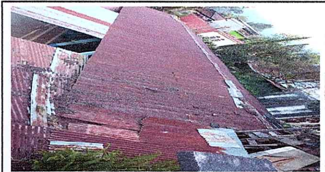
Foto 4: Reemplazar o cambiar todo el techa en 8 aulas y una cocina.
