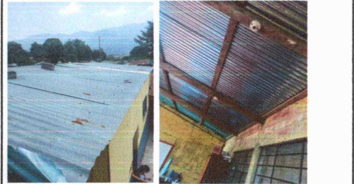
FOTO 4: Módulo 2, sustitucion de lámina y Sustitucion de soporte de madera por metal.
