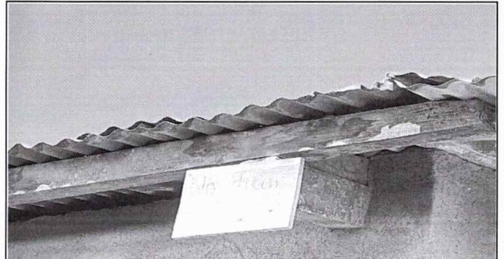
Foto 2: MODULO 1. Vista de lamina deteriorada.
