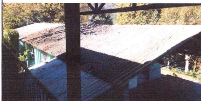
Foto 1: Techo lateral de módulo a cambiar láminas
