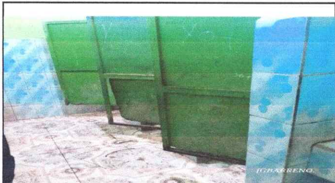
Foto 3: Puertas por sustituir sanitario niños
