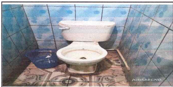
Foto 5: 8 sanitarios por sustituir
