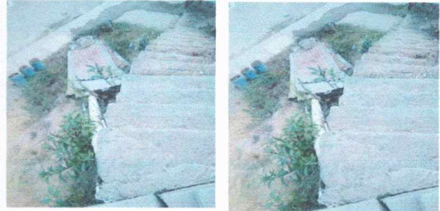
Foto 2: sustitucion, y Ampliacion de gradas . Ya que varios estudiantes se han caido.
