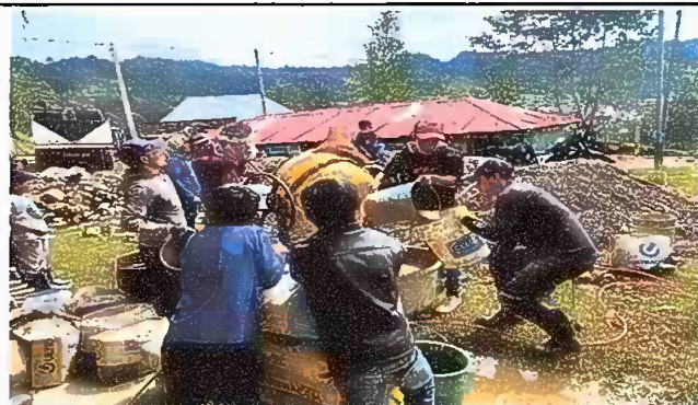
Foto 2: reparacion de muro perimetral de block con tibo hg y malla y galbanizado soleras intermedias y columnas.
