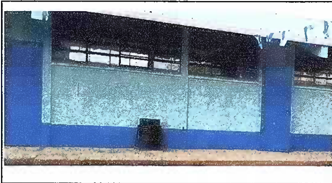
Foto 3: modulo 1 Mantenimiento a estructura (lijado, cambio de tubo , cepillado, sujeciones, aplicación de pintura)
