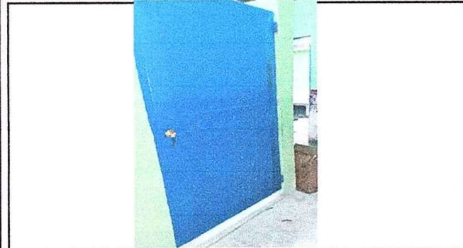
Foto 7: Modulo 1 Mantenimiento de puertas de metal en baños. EODP. Anexa a EORM. Aldea Chuaquenum, Joyabaj, Quiché.
