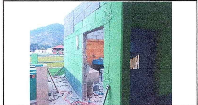
Foto 4: Módulo 1 Sellado de vano. EODP. Anexa a EORM. Aldea Chuaquenum, Joyabaj, Quiché.
