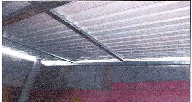
Foto 2: Módulo 1. Sustitucion de estructura de soporte de madera por metal. EODP. Anexa a EORM. Aldea Chuaquenum, Joyabaj, Quiché.
