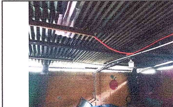
Foto 2: Módulo 2. Sustitucion de estructura de soporte de madera por metal. EODP. Anexa a EORM. Aldea Chuaquenum, Joyabaj, Quiché.
