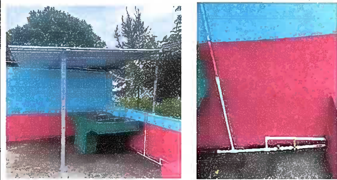
Modulo 4: Sustitución de pila de cemento de dos lavaderos, sustitución de llave de globo, llave de chorro e instalación de estructura portante de metal.
