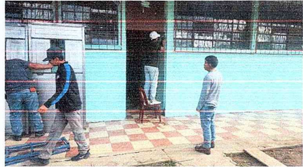
Foto 2: MODULO 1: Sustitucion de puerta de metal y pintura en muros exterior e interior.
