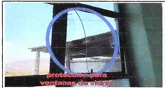
Foto 4: Vidrios dañados por falta de protección, es necesario la colocación de balcones.
