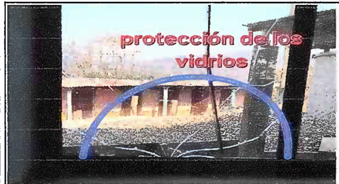
Foto 3: Vidrios dañados por falta de protección, es necesario la colocación de balcones.
