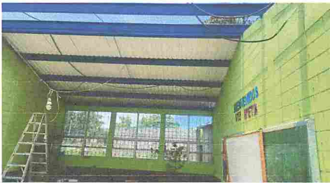
Foto 3: MÓDULO 1: Instalación de lámina troquelada y mantenimiento de estructura portante de metal.
