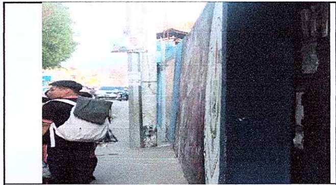
Foto 2: Pared de muro perimetral desplomada, vista frontal.
