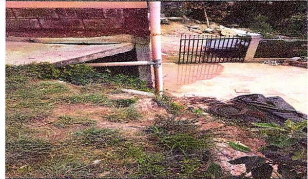
FOTO: 2 VISTA SUPERIOR DONDE COLAPSÓ EL MURO DE CONTENCIÓN.
