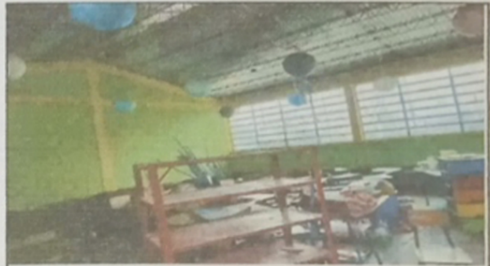
Foto 4: Pintura interior de la escuela
