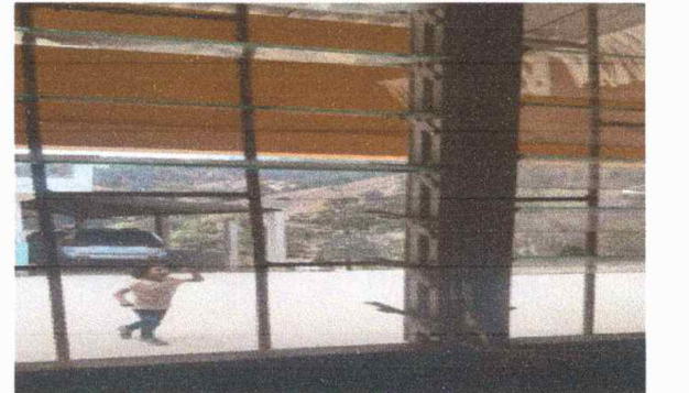
Modulo 3 Foto 10: Sustitución de estructura de metal, vidrio de ventana y balcones de metal
