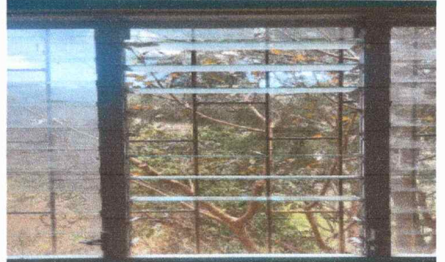
Modulo 3 Foto 8: Sustitución de estructura de metal, vidrio de ventana y balcones de metal
