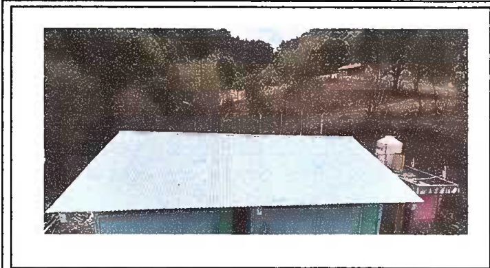
Modulo 1 Sustitución de lámina de duralita por lamina troquelada, sustitución de estructura de soporte de metal por metal y sustitución de capote
