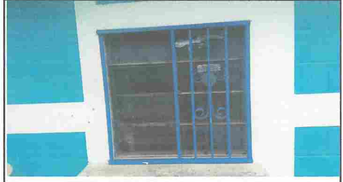
Foto 8: Proceso de instalación de balcon de la Cocina para protección de vidrios
