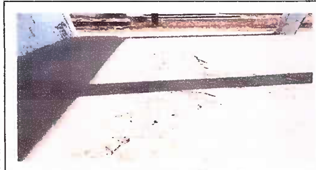
Foto 1: PISOS DE CORREDOR EN MAL ESTADO
