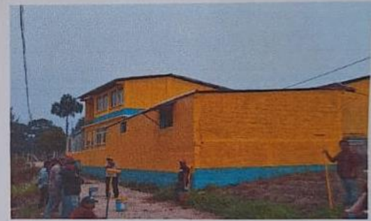
Foto 4: PINTURA EN MUROS EXTERIORES E INTERIORES, 8 AULAS, COCINA Y BAÑOS, INTERIOR Y EXTERIOR.
