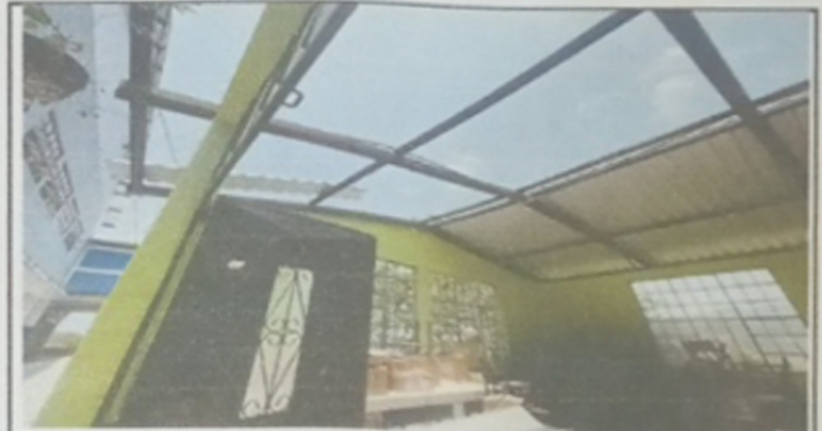
Foto 4: Módulo 2, instalación de lámina troquelada aluzinc calibre 26 y capote de lámina para lámina troquelada.
