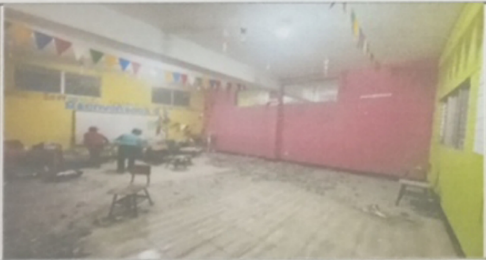
Foto 5: Módulo 3, Ruptura de paredes para colocación de ventanas PVC y mejorar la iluminación natural.
