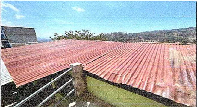
Foto 4: Sustitución de lámina, por lámina troquelada aluzinc calibre 26 Y sustitución de capote de lámina para lámina troquelada.
