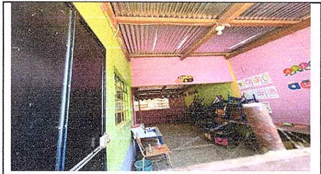
Foto 3: Sustitución de estructura de soporte de madera, por metal y colocación de balcón.
