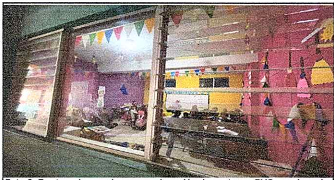
Foto 5: Ruptura de paredes para colocación de ventanas PVC y mejorar la iluminación natural.
