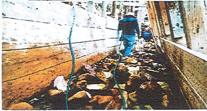
FOTO 1: MODULO 1: Reparacion de Muro de contencion
