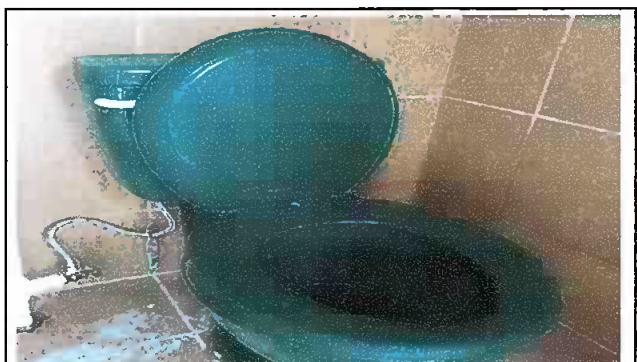
Módulo 4: Sustitución de accesorios inodoro (contra llave, tubo de abasto y tanque)
