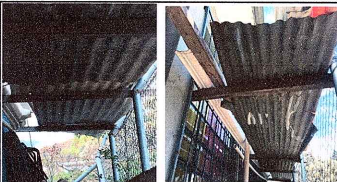
Foto 9: MODULO 2. Sustitución de estructura de soporte de madera, por metal. Sustitución de lámina, por lámina troquelada aluzinc calibre 26.
