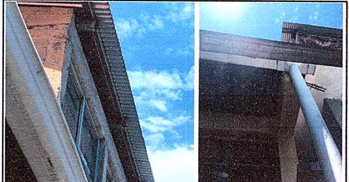
Foto 8: MODULO 2. Sustitución de canal de pvc por metal, Sustitución de bajada de agua pluvial de PVC
