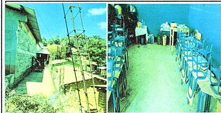
Foto 5: Modulo 2 Reparación de muro perimetral de block con tubo hg y malla galvanizada, solerasn intermedias y columnas, Sustitución de piso de concreto.
