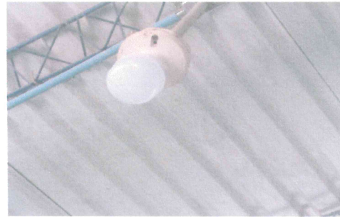
Modulo 1. Sustitucion de focos ahorradores
