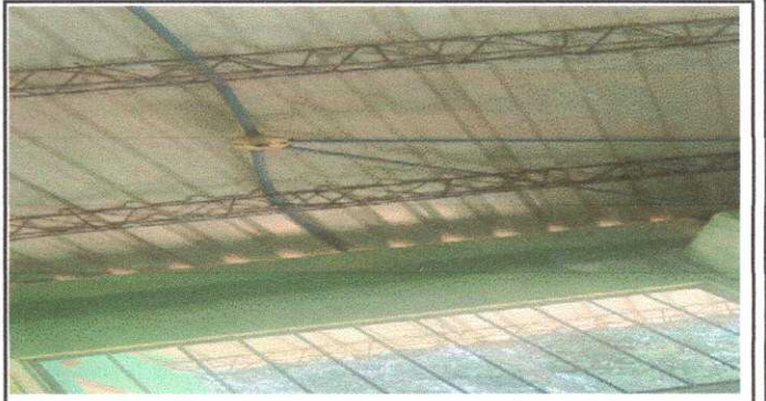
Modulo 1. Sustitucion de focos ahorradores
