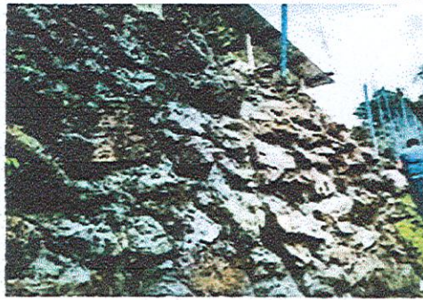
FOTO 1: MODULO 1: Reparacion de Muro de contencion
