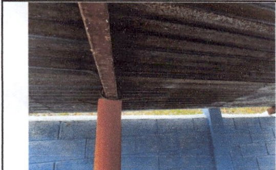
Foto 7: TECHO DEL AREA DE COCINA CON BASES IMPROVISADAS DE TUBERIA DE PVC
