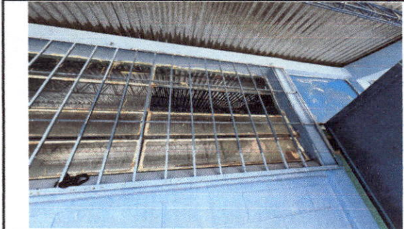
Foto 2: VIDRIOS QUEBRADOS EN PARTE POSTERIOR DE LAS AULAS
