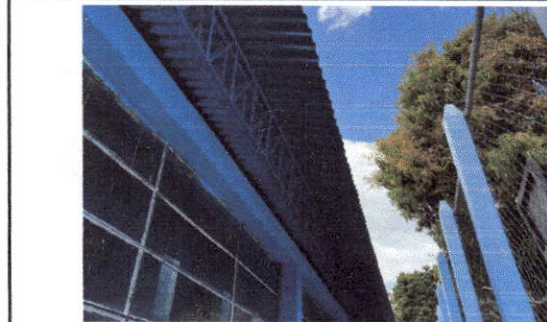
Foto 3: FALTA DE CANAL DE METAL PARA BAJADAS DE AGUA EN PARTE POSTERIOR DE AULAS.
