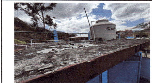
Foto 4: PAÑUELOS INEXISTENTES EN LOSA DONDE SE UBICA DEPOSITO DE AGUA
