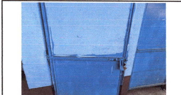
Foto 6: PUERTAS DE LOS SANITARIOS EN MAL ESTADO Y DAÑADAS.
