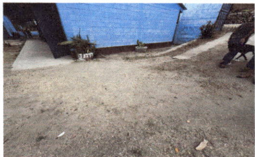
Foto 9: ACCESO PRINCIPAL, SEGUIDO DE UNA RAMPA DE ACCESO, ES UNICAMENTE DE TIERRA.
