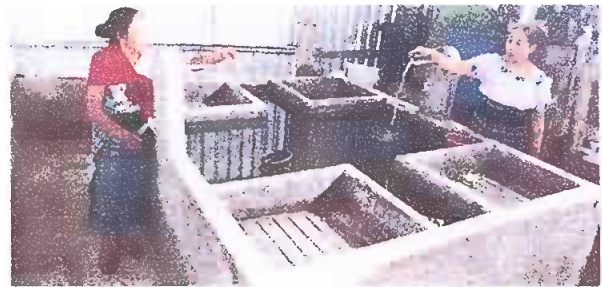
Foto 4: Modulo 1. Esta es la culminacion de construccion de la pila de de 4 lavaderos.
