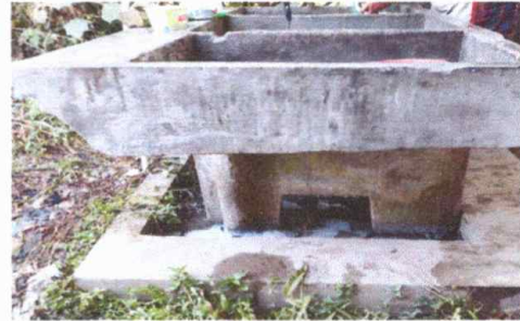
Foto Modulo 1 Sustitucion de pila de concreto de dos labaderos a 4 labaderos (pilona)
