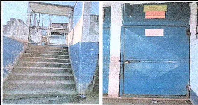
Foto 1 de Modulo 1: Mantenimiento a estructura de porton de metal(lijado,sepillado sujisiones, aplicación de pintura y cambio de malla hg). Sustitucion de puertas de metal por metal.
