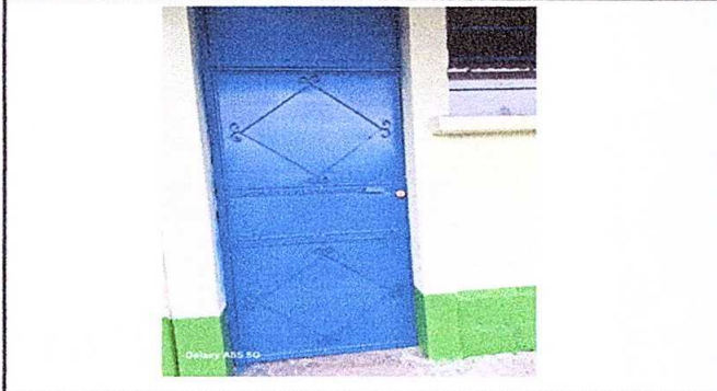
Foto 1: MODULO 1 Mantenimiento a estructura de puerta (lijado,cambio de tubo,cepillado, sujecion, aplicacion de pintura)
