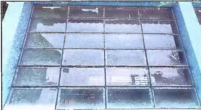
Foto 3: Sustitución de vidrios de ventanas que están en mal estado en el centro educativo.
