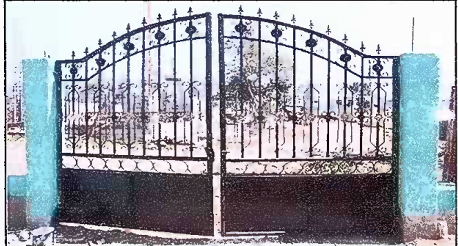
Foto 2: Sustitución de portón con base de lámina, con barrotes tipo colonial y puntas de lanzas de 3.14 metros por 2.70 de alto; con base de concreto.
