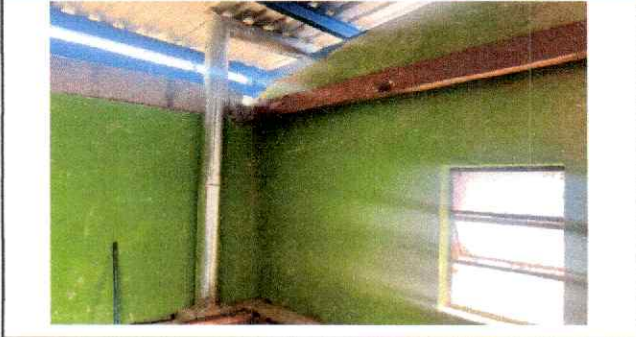
Foto 3: Se observa el remozamiento en estufa rural, ya cuenta con cambio de chimenea en estufa rural.
