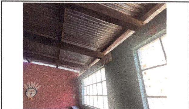
Foto 10: Lamina deteriorada, vista desde el interior de aula 1.
