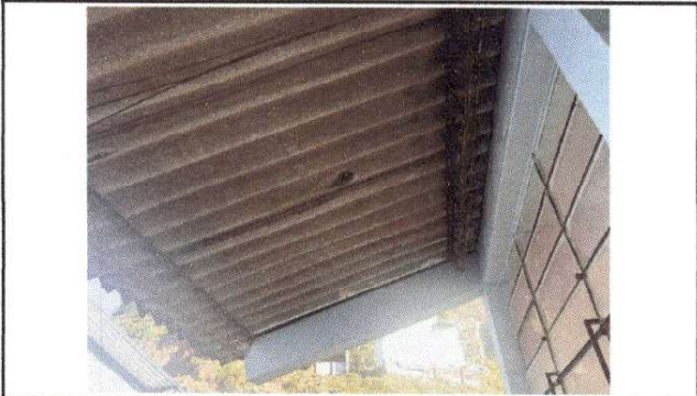
Foto 9: Se puede observar agujeros en lámina de módulo de aulas.
