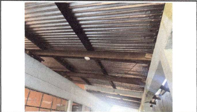
Foto 7: Lamina deteriorada en área de corredor.
